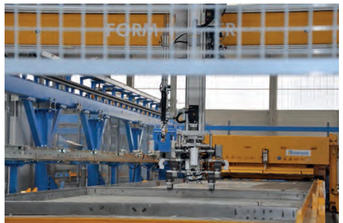
可同时运输两块模板的特殊版本模板机器人，以及绘图与清洗/脱模剂喷涂工位。模板在这里由机器人拆除，通过传送轨道进行清洗，然后运到模板仓库
