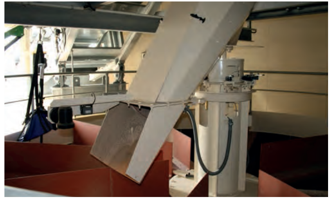
骨料由旋转的布料机倒入适当的储料仓中。对于大直径骨料，内置工序确保材料妥善倒入仓中
