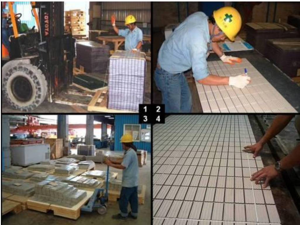
图 11. (1) PE 胶膜瓷砖进厂，(2) 瓷砖分割加工，(3) 完成一构件用量，(4) 排砖入钢模
