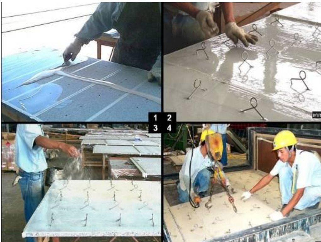
图 16. (1) 石材背涂防水胶, (2) 石材扣上爪钉, (3) 防水材撒上石英砂, (4) 石材入模
